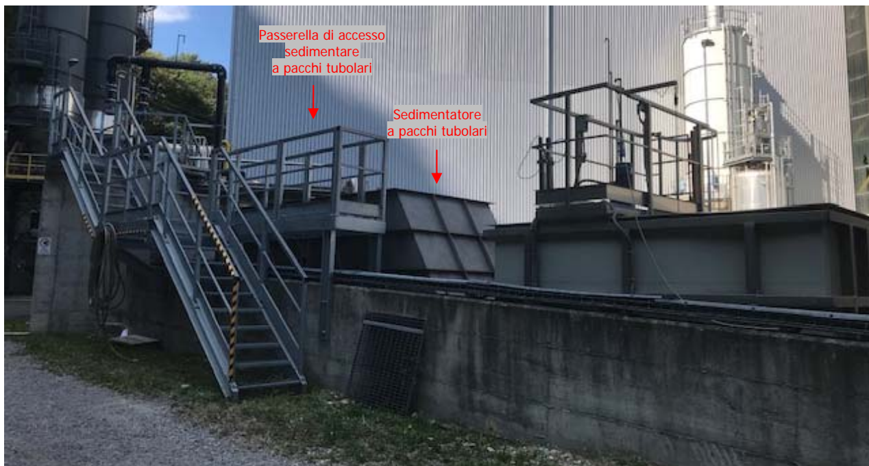
Foto 3 – Scala e passerella esistente di accesso al sedimentatore a condotti tubolari
