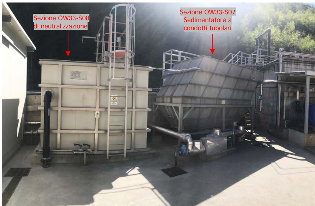
Foto 1 – Vista sezione di neutralizzazione con scala alla marinara di accesso alla sommità
