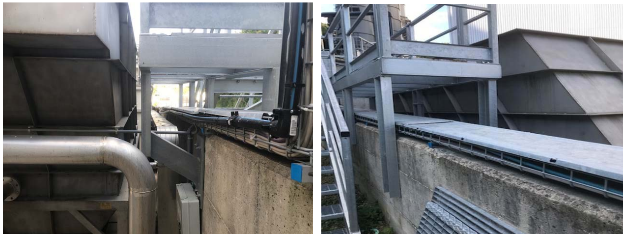
Foto 4 e Foto 5 – Particolare della passerella esistente di accesso al sedimentatore a condotti tubolari
