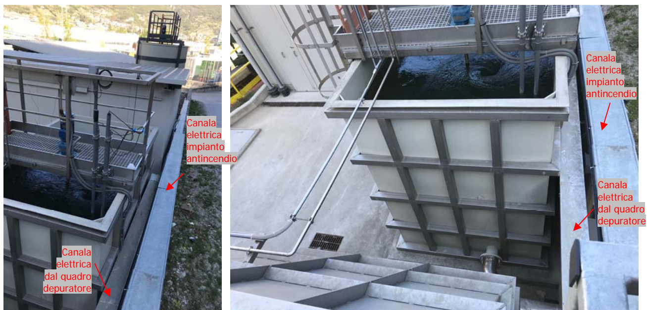
Foto 6 e Foto 7 – Canale vie cavi elettrici presenti sul muro a tergo della vasca
